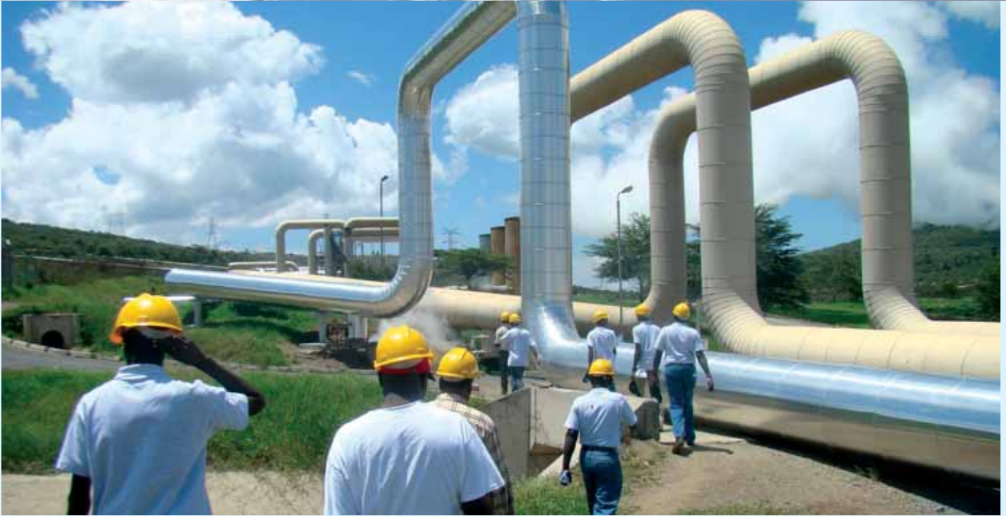
Planta geotérmica Olkaria II, Kenya.
